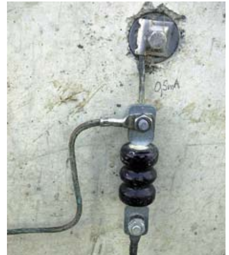
L'éclateur de paratonnerre joue un rôle tampon entre le paratonnerre et les autres structures métalliques.
