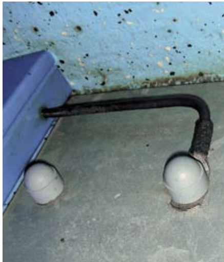
En reliant les parties métalliques à la mise à terre, on dévie les courants vagabonds en direction du sous-sol.
