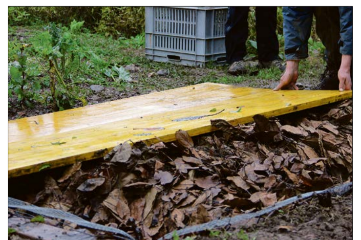
Über die Strohisolation kommen eine Wolldecke, Nussbaumlaub, ein Abdeckvlies, Schaltafeln und nochmals ein Abdeckvlies.
